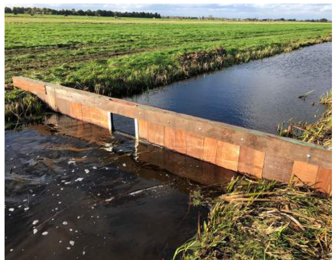
Door middel van planken in de opening van de damwand kan de hoogte van het peil geregeld worden
